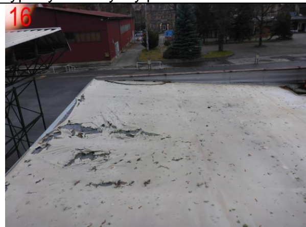
Foto č.16: Pohled na střešní krytinu přístavku. Zcela zdegradovaná fólie - typický stav krytiny přístavku
