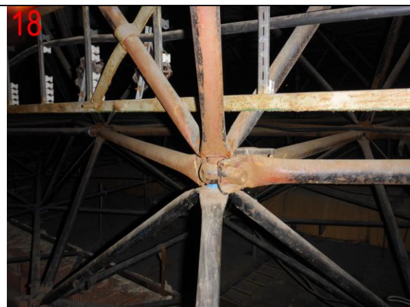
Foto č.18: Povrchová koroze některých prvků příhrady. Provedení styčnicku.
