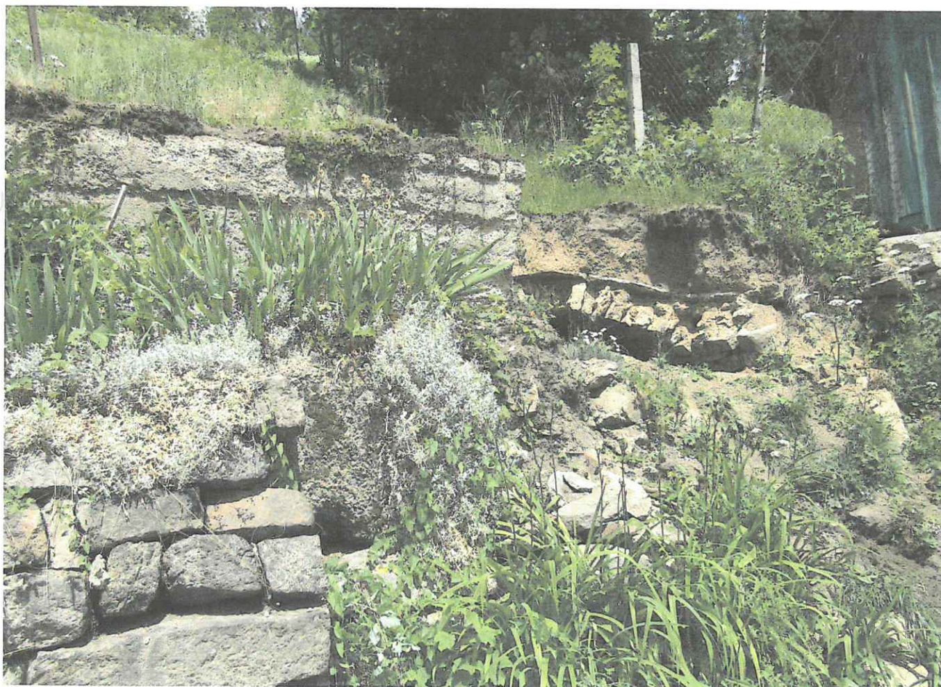
k.ú. Kateřinky u Liberce p.p.č., 38 špatně založená posunutá opěrná zeď – nutno odstranit
