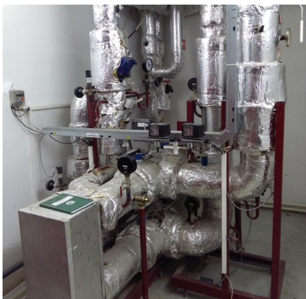
Obr. č. 5 – Výměňková stanice
