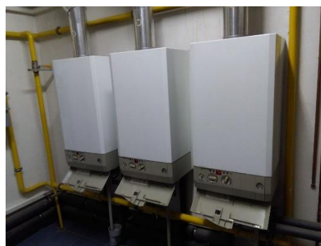
Obr. č. 6 – Kotelna budova 18A
