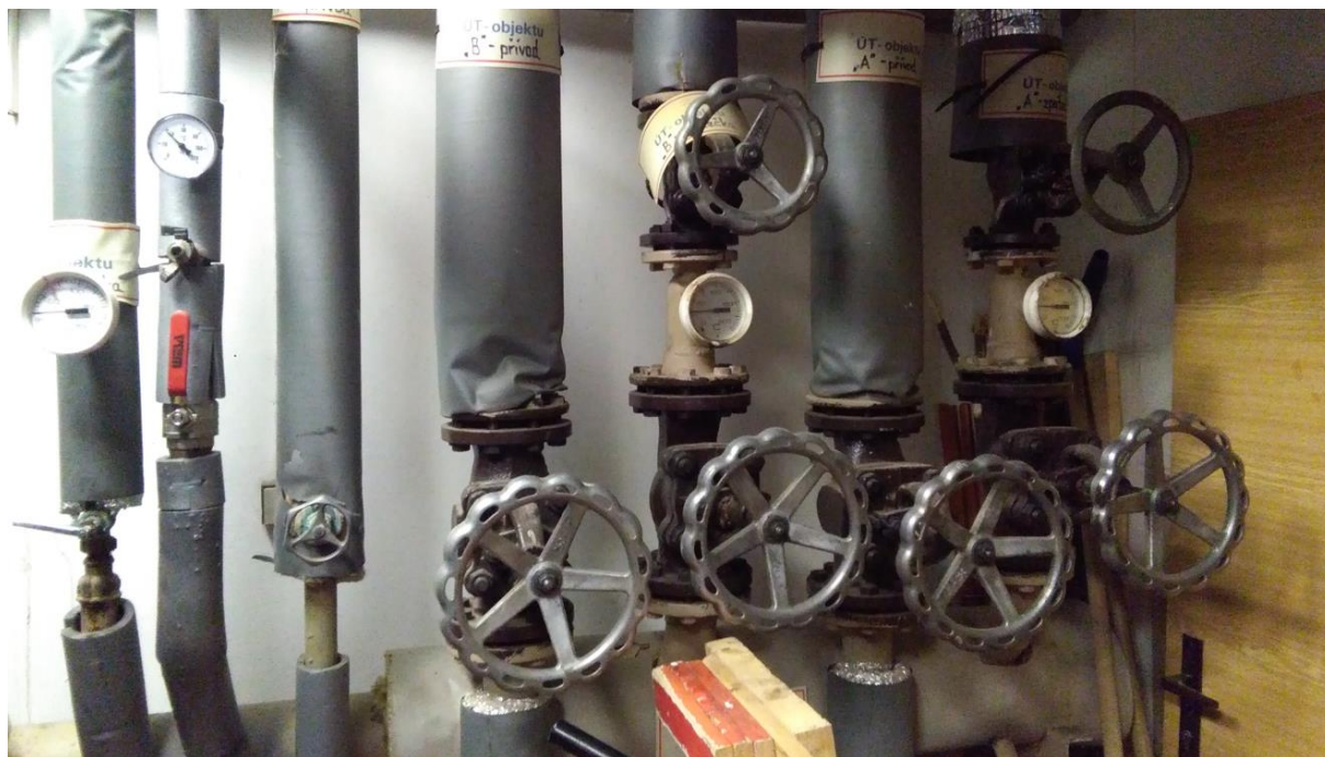
Obr. č. 53 - Rozdělovač topné vody
