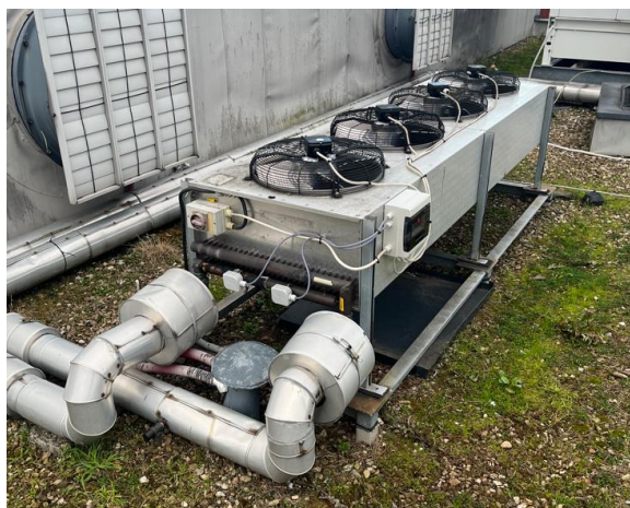
Obr. č. 8 – VZT na střeše objektu
