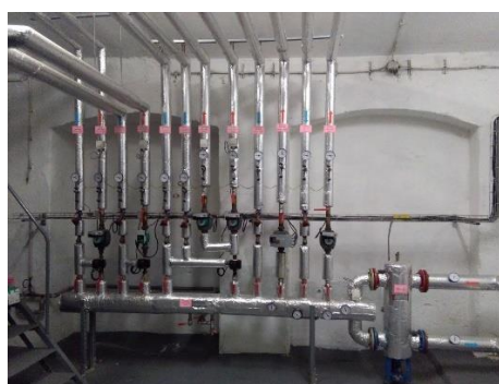
Obr. č. 4 – Kotelna hlavní budova
