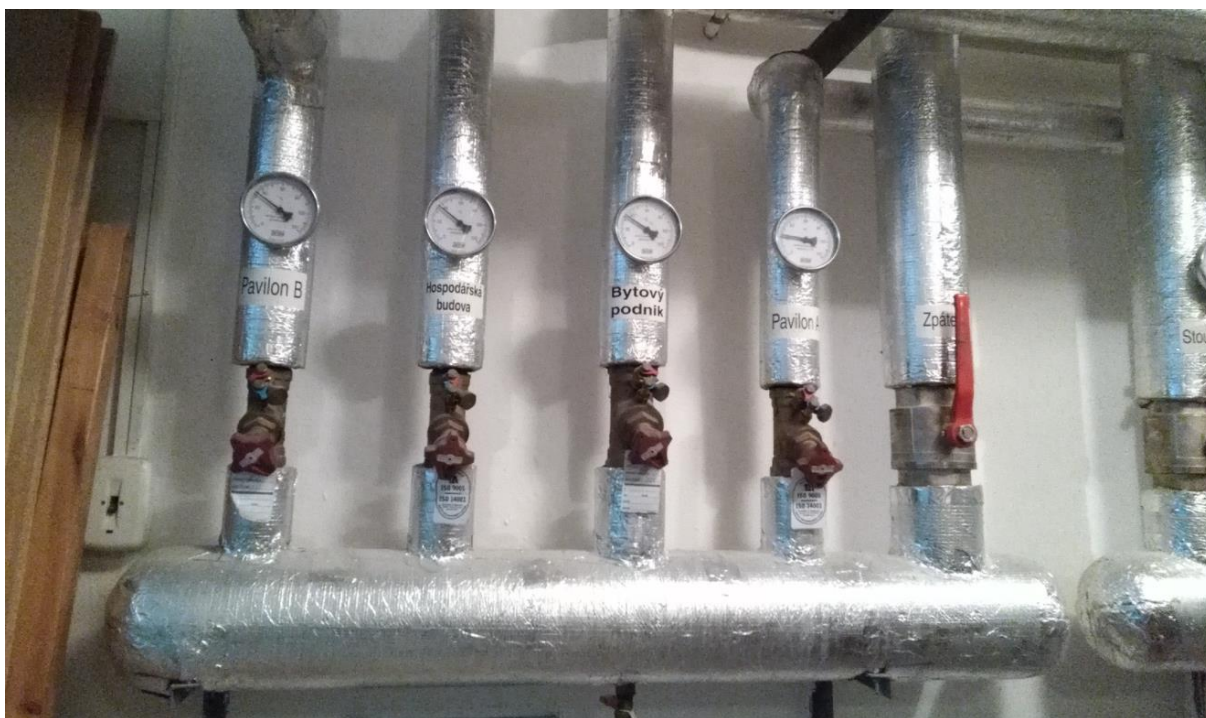
Obr. č. 13 - Rozdělovač topné vody
