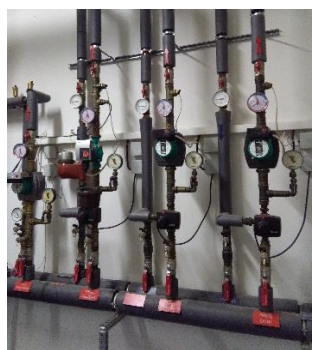
Obr. č. 5 – Kotelna budova 18A
