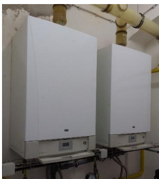
Obr. č. 3 – Kotelna hlavní budova
