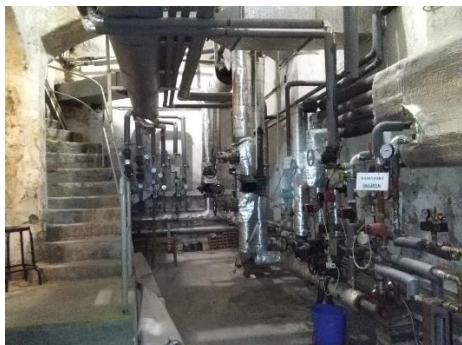
Obr. č. 3 – Výměňková stanice
