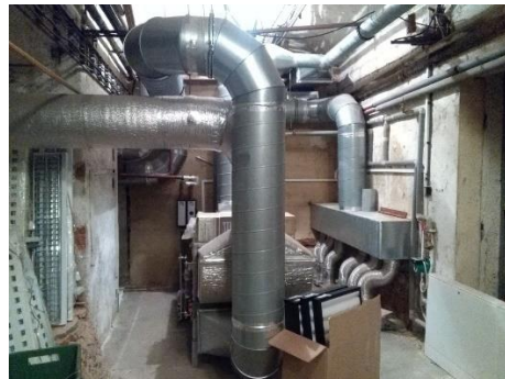
Obr. č. 4 – Vzduchotechnika
