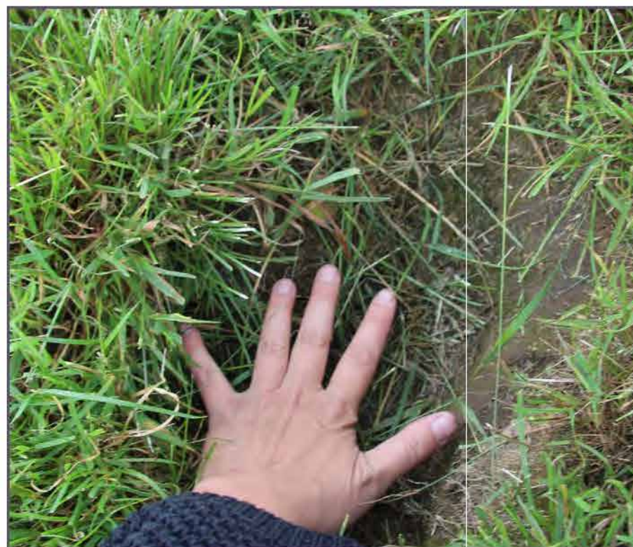
Erozní rýha ve vzdálenosti cca 3 metrů od hranice vody naznačující nestabilitu břehu.
