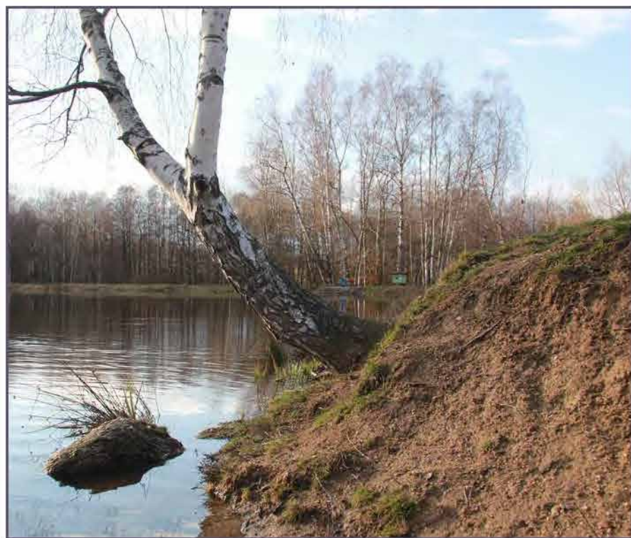
Eroze břehů v blízkosti stávajícího schodiště.
