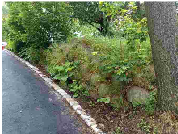
Obr.5: Vstupní pěšina, Obr.6: Betonová zárubní zeď - zaplevelená
