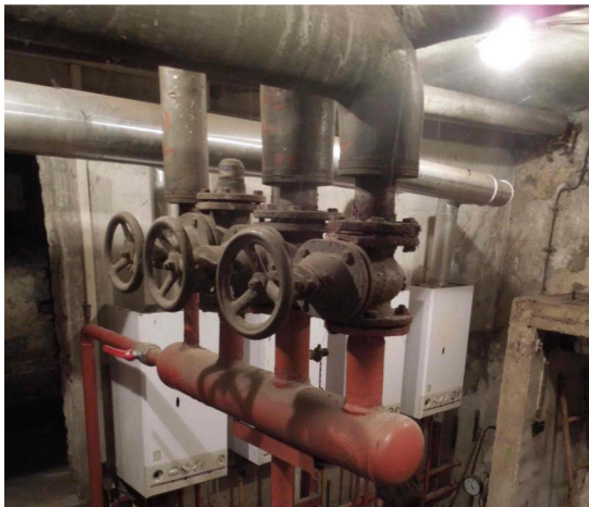
Zdroj tepla – kaskáda 4ks plynových kotlů Lamborghini – 1kotel záložní
