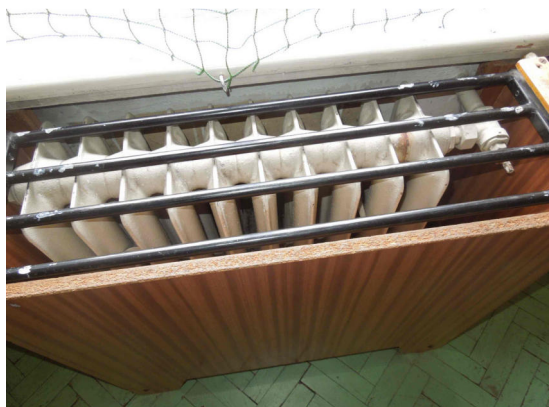
Článeková litinová otopná tělesa v dřevěné konstrukci v tělocvičně, bez TRV
