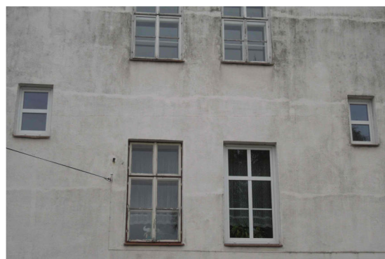
Detail oken původních a nových plastových
