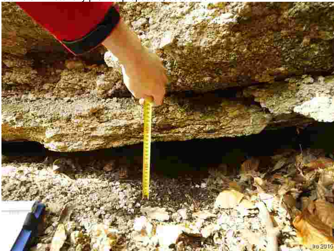
Stavidlo 2: Betonový překlad propustku, destrukce
