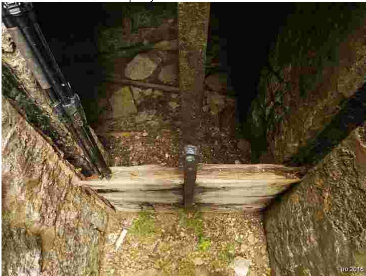
Stavidlo 6: Poškozené vodící profily
