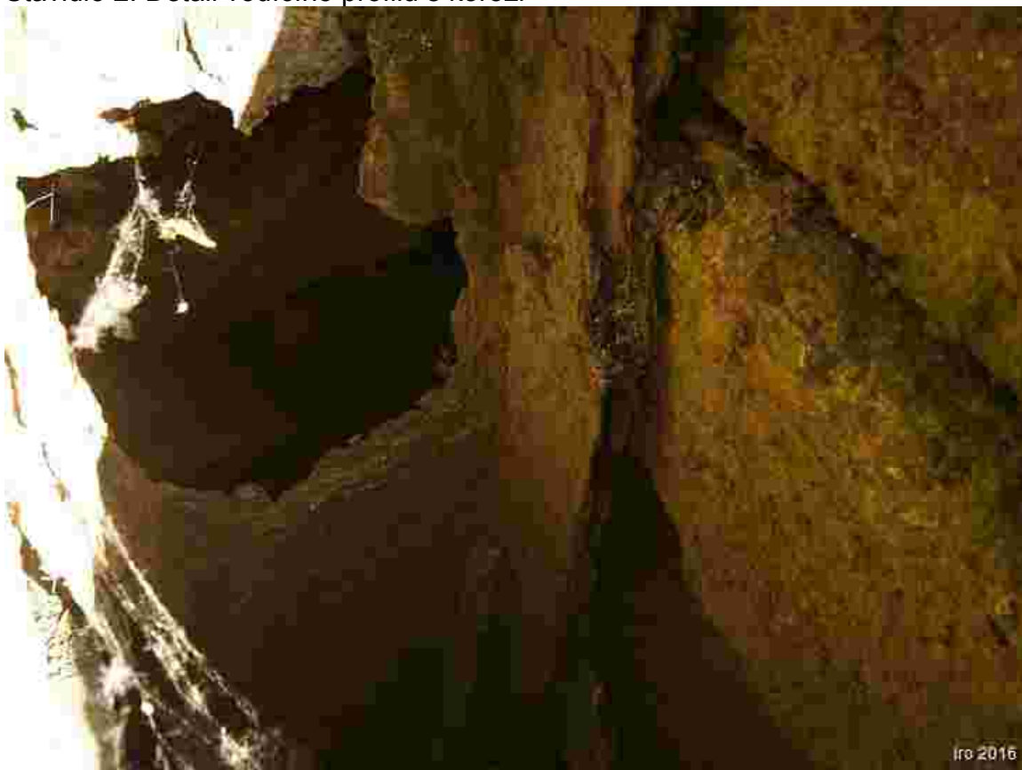
Stavidlo 2: Detail vodícího profilu s korozi
