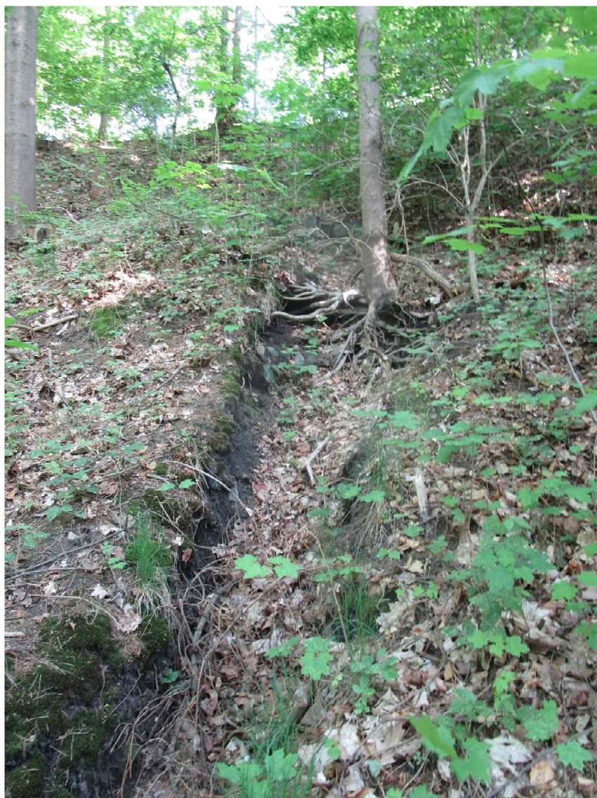
Erozní rýha k sanaci z propustku, občasná vodoteč z ul. Gen. Svobody u stavidla č. 2
