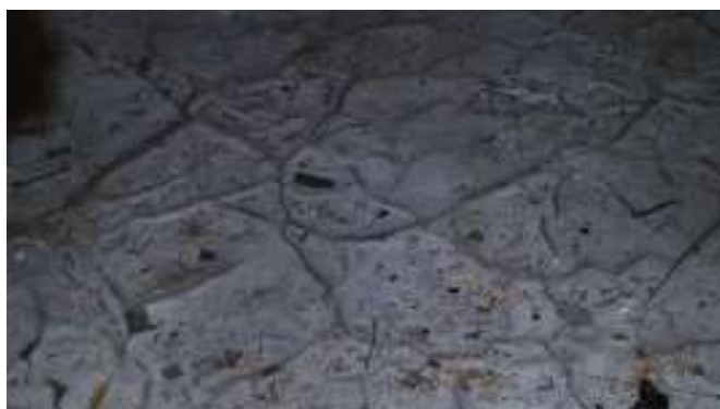
foto /32/ Pohled na degradovaný povrch asfaltového pásu s hliníkovou vložkou a horním nátěrem
