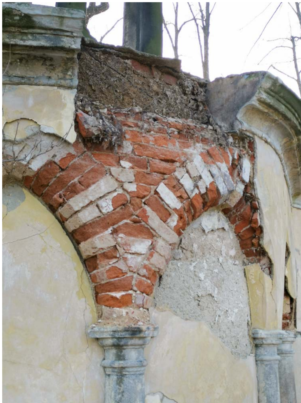
6. Detail poškozené arkády se zřícenou korunní římsou
