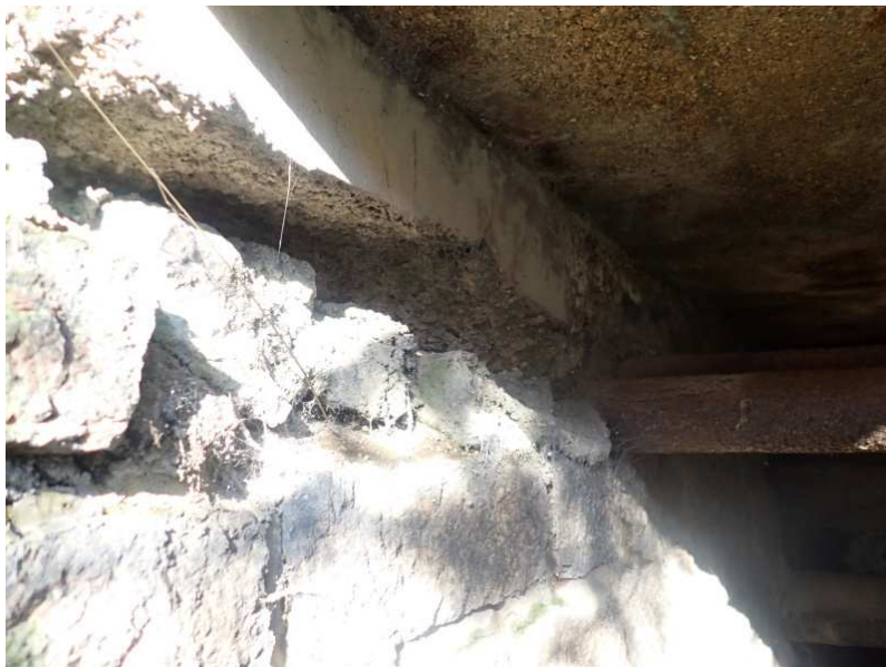
Silná degradace betonu v koruně pravobřežní opěry na výtoku
