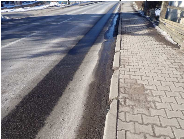
Poškozený betonový obrubník podél vtok. chodníku – degradace betonu a lokálně beton zcela chybí
