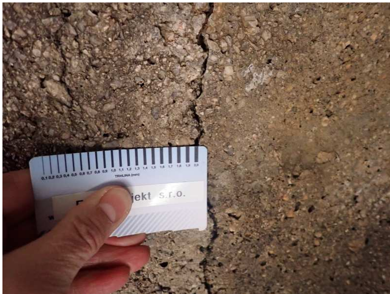
Detail trhliny v pohledu NK v rozšíření na výtoku o tl. 2 mm
