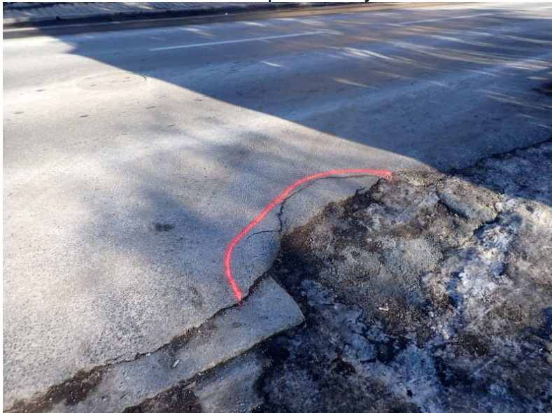
Poškozená krajnice na výtoku vpravo, v místě odbočky do areálu stavební firmy
