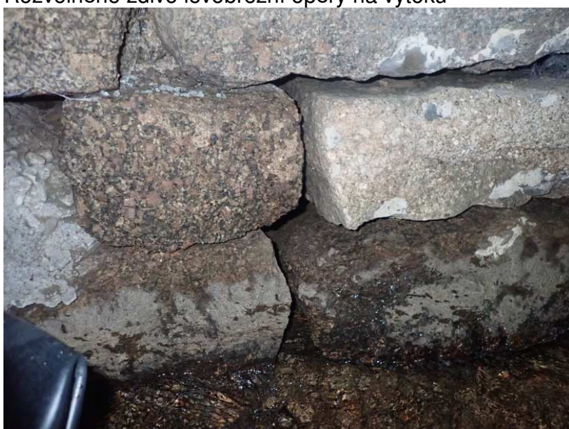
Rozvolněné zdivo na výtoku levobřežní opěry – kaverna do hl. 50 cm
