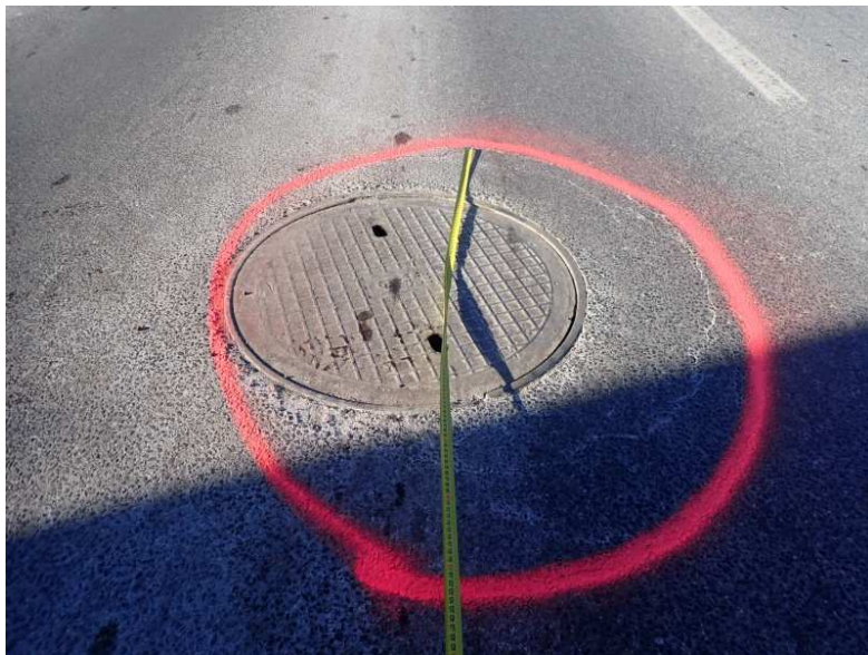
Síť trhlin v blízkosti ocel. poklopu na pravobřežním předpolí
