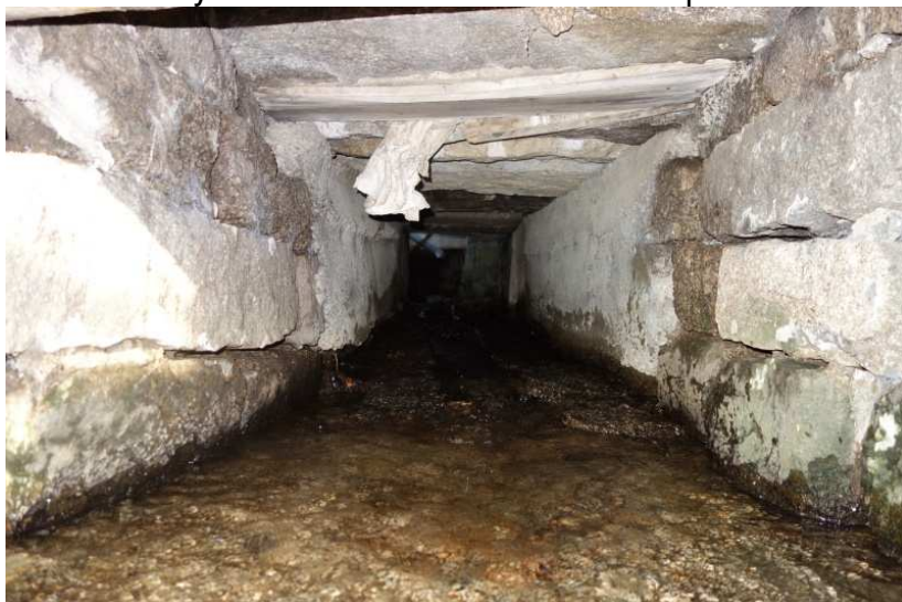
Pohled NK pod MK, včetně poškozeného spárování kamenných opěr
