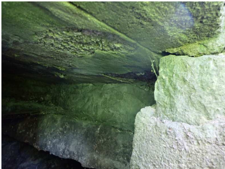
NK v místě rozšíření na vtoku + degradace betonu
