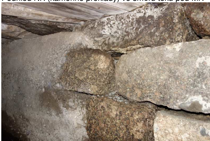
Rozvolněné zdivo levobřežní opěry na výtoku
