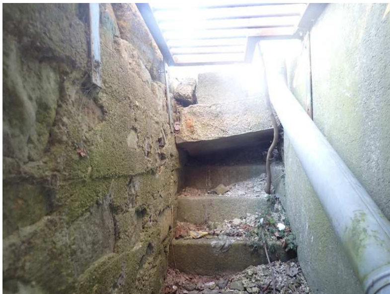
Nefunkční schodiště na vtoku vpravo
