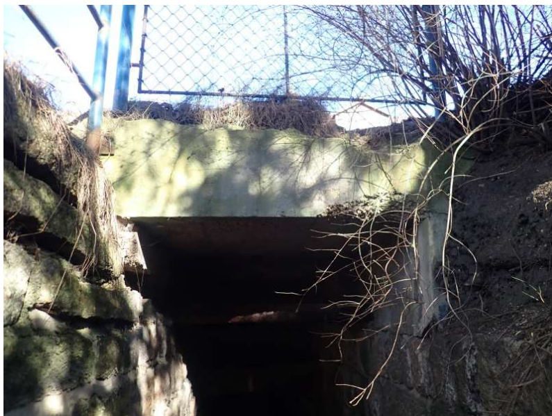
Pohled na bok NK na výtoku, resp. římsu, s degradací betonu
