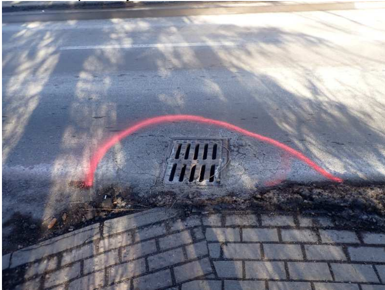
Síť trhlin v blízkosti uliční vpusti na výtoku vlevo
