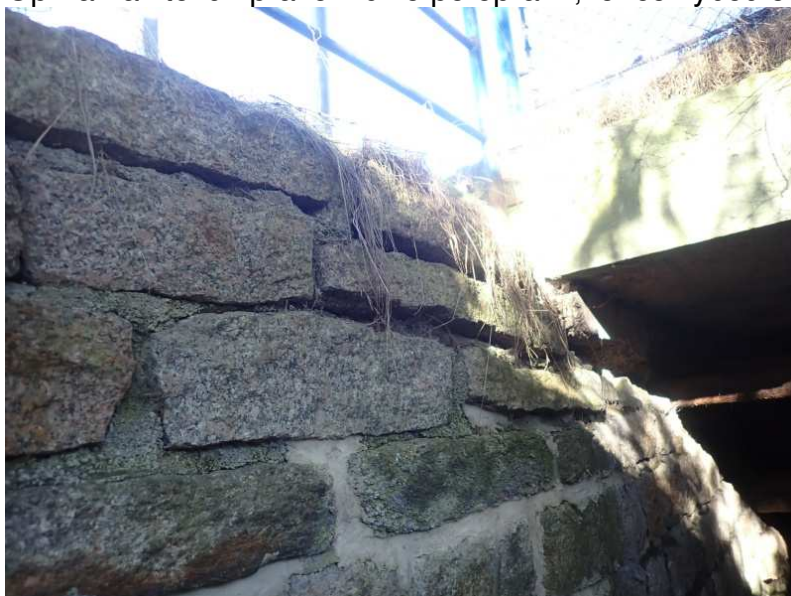
Chybějící spárování v koruně výtokového křídla vpravo
