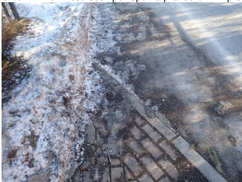
Poškozený betonový obrubník na výtoku – podélné trhliny
