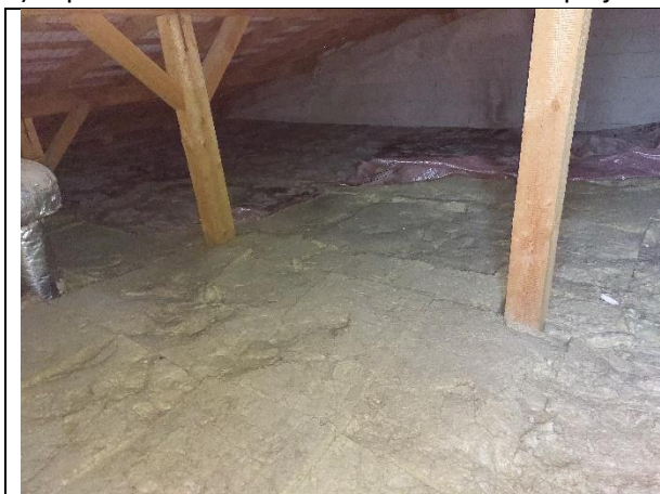
Tepelná izolace s viditelným kondenzátem od krytiny, prošlapaná izolace, zbytky fólie
