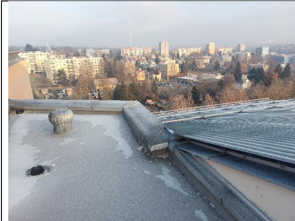
Hydroizolace u stěn vyvedena do malé výšky a velké deformace tepelné izolace při chůzi
