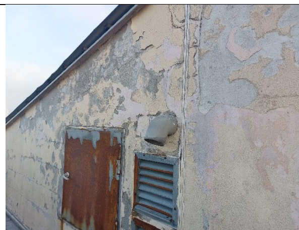
Stěna strojovny je vlhká, protože není zateplená a nad stěnou je střecha bez přesahu
