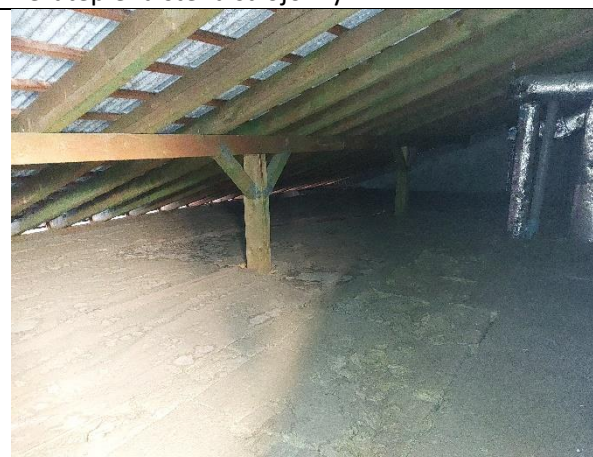
Tepelná izolace s viditelným kondenzátem od krytiny, prošlapaná izolace, zbytky fólie
