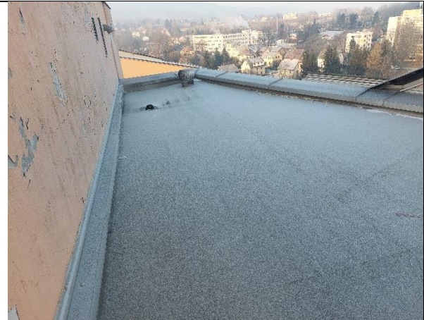
Hydroizolace u stěn vyvedena do malé výšky a velké deformace tepelné izolace při chůzi
