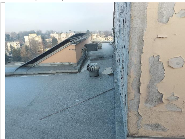
Nezateplená železobetonová stěna výtahové šachty, degradace omítky
