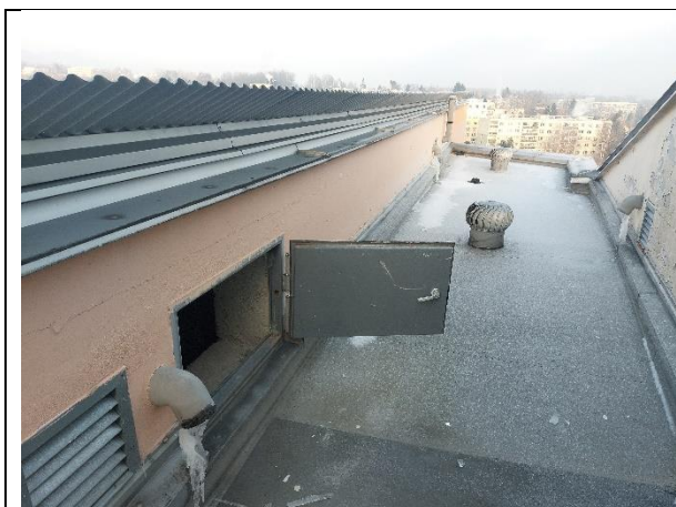
Neprovedené odvětrání krovu u štítu, krytina bez přesahu
