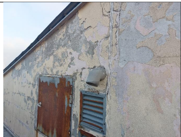
Nezateplená železobetonová stěna výtahové šachty, degradace omítky
