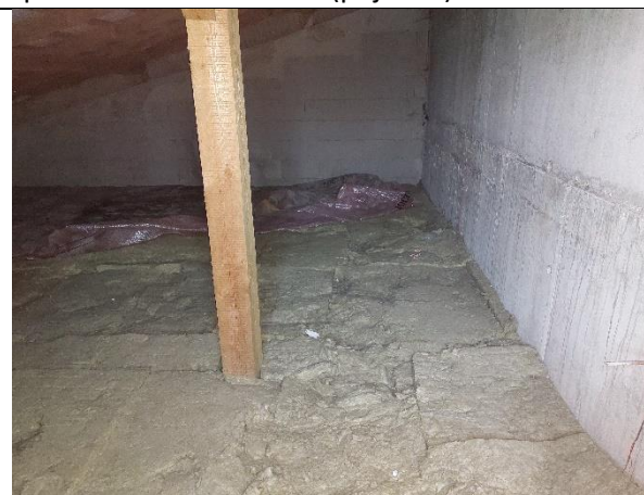
Tepelná izolace s viditelným kondenzátem od krytiny, prošlapaná izolace, zbytky fólie, nezateplená stěna strojovny
